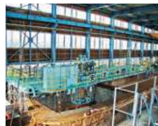
電車台車枠用クラフトロリー式 天井クレーン(10t、スパン20m)
