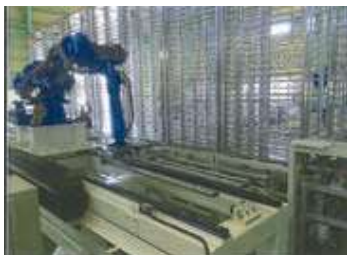
ガラスストッカー及び出入庫装置
